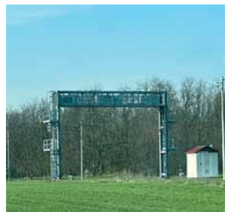
Stanica za automatski nadzor tehničkog stanja željezničkih vozila
