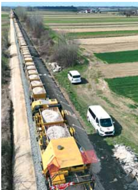
Pružno postrojenje – kiblice s materijalom
