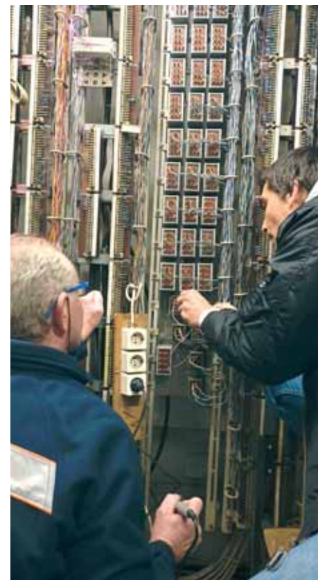
Kolege na održavanju TK sustava na Postavnici
