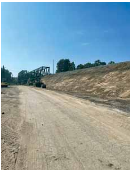
Novi pokos nasipa od km 317+171 do km 317+276
