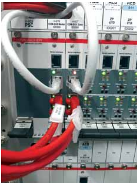
Sučelje Interlocking (Siemens) – brojač osovina (Frauscher)
