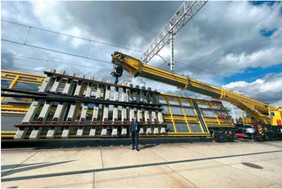
Stroj za izmjenu skretnica
