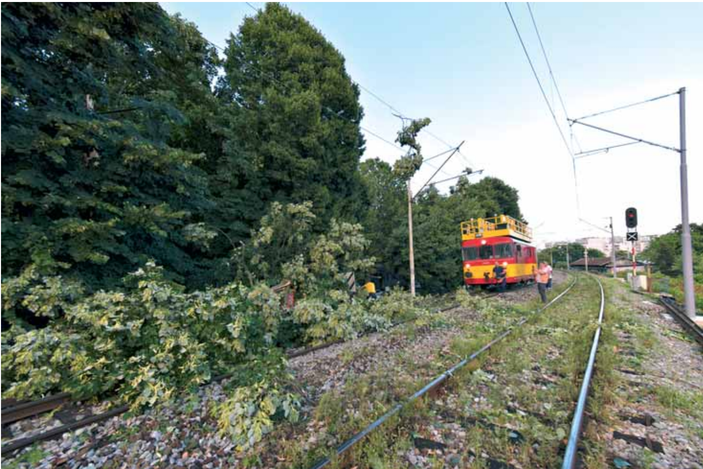
Radnici HŽI-a otklanjaju posljedice nevremena na pruzi između Glavnog i Zapadnog kolodvora u Zagrebu, između Crnatkove ulice i Studentskog centra
