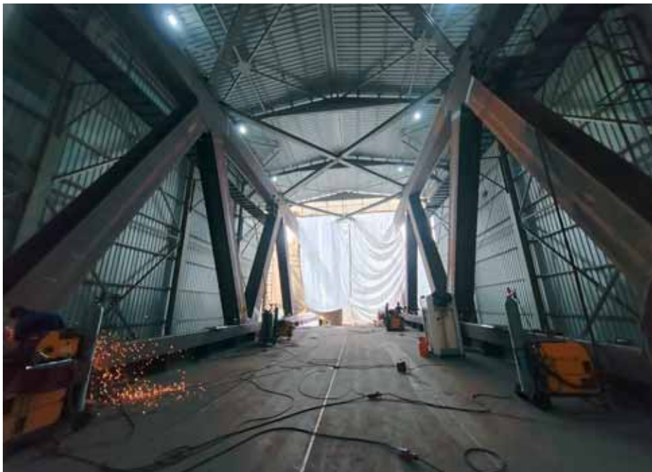
Radnici su podignuli šator unutar kojega vare, pjskare i boje most. Šator se kreće po tračnicama. Kada završe radove na jednome dijelu mosta, on se pomiče prema naprijed.
