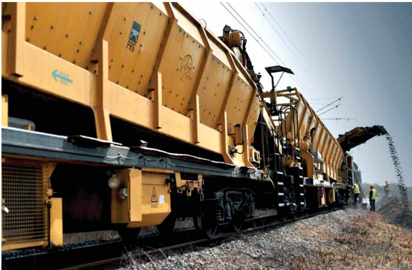
Kompozicija radnih strojeva na gradilištu od Velike Gorice prema mostu na Savi
