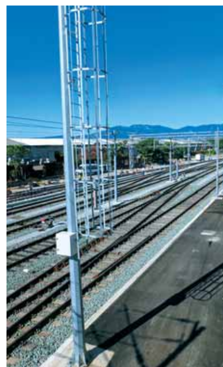
Skretničko područje s rasvjetnim stupom na teretnom dijelu kolodvora
