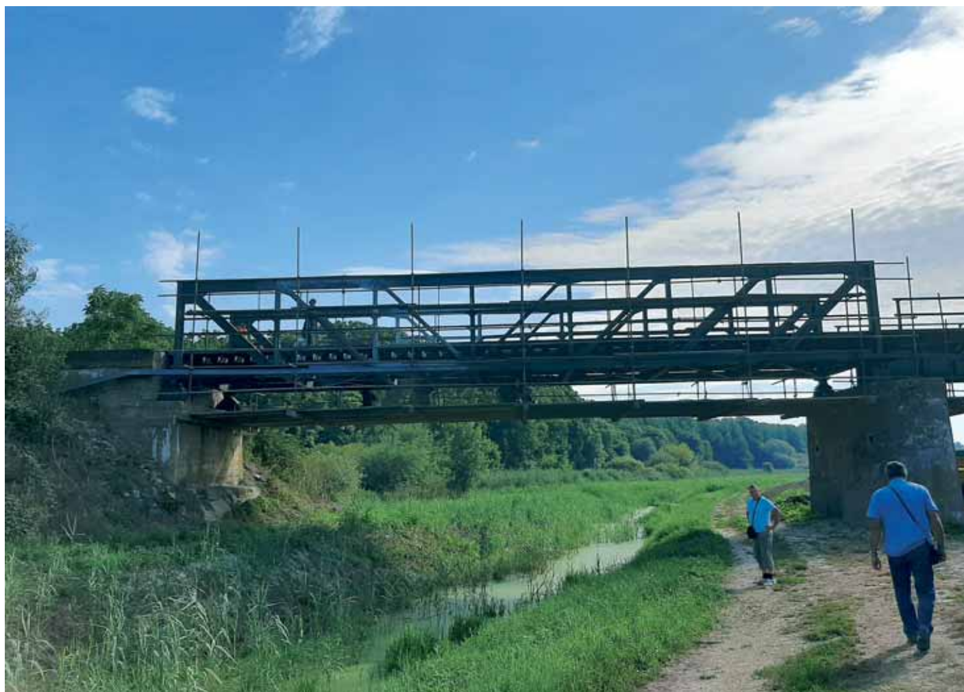
Viseća skela 1. konstrukcije
