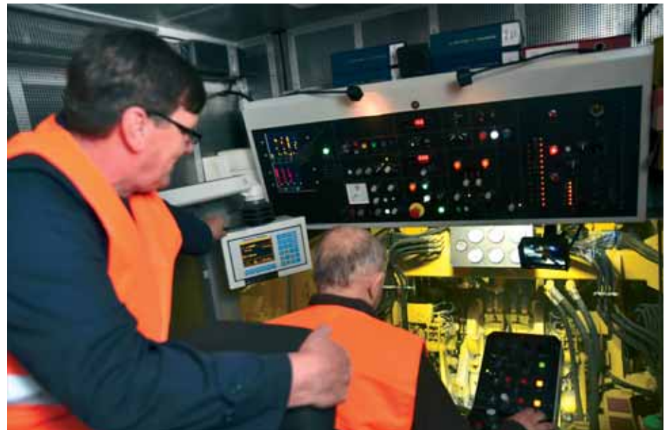
Brigadir i strojovođa Jure Vidak te rukovatelj strojem Mario Duh za kontrolnim pultom podbijačice
