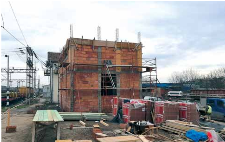
Zgrada postrojenja za sekcioniranje Vinkovci
