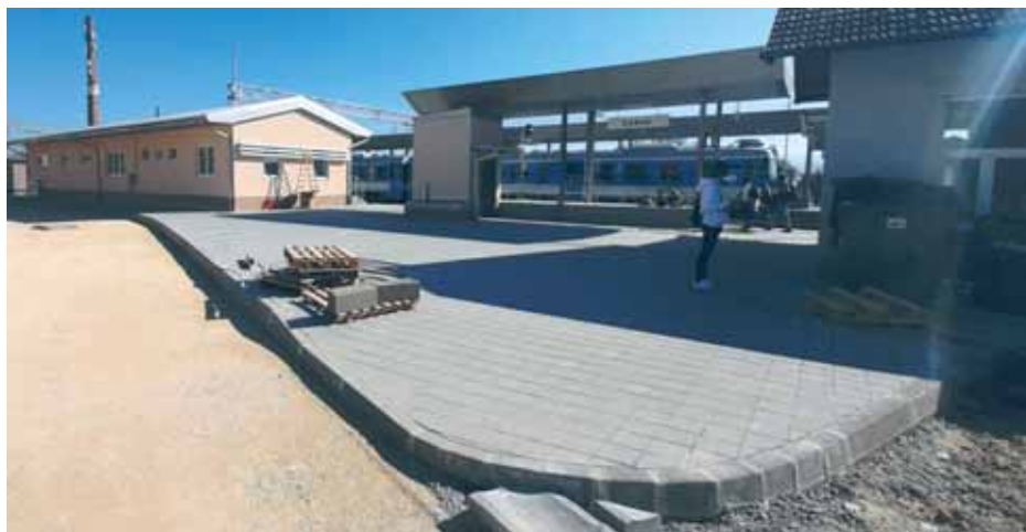
Završni radovi na opločenju oko nove zgrade SS i TK – kolodvor Zabok
