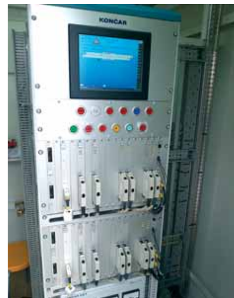
Uređaj za osiguranje željezničko-cestovnog prijelaza tip KLC3
