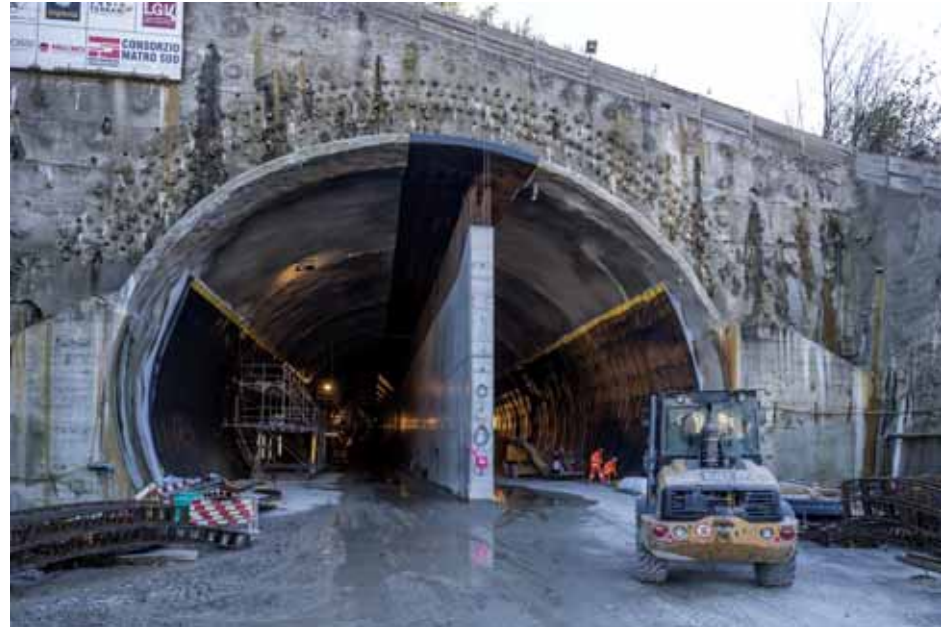
Portal tunela Ceneri 2016. prije nego što se u tunelu počeo graditi željeznički kolosijek.
